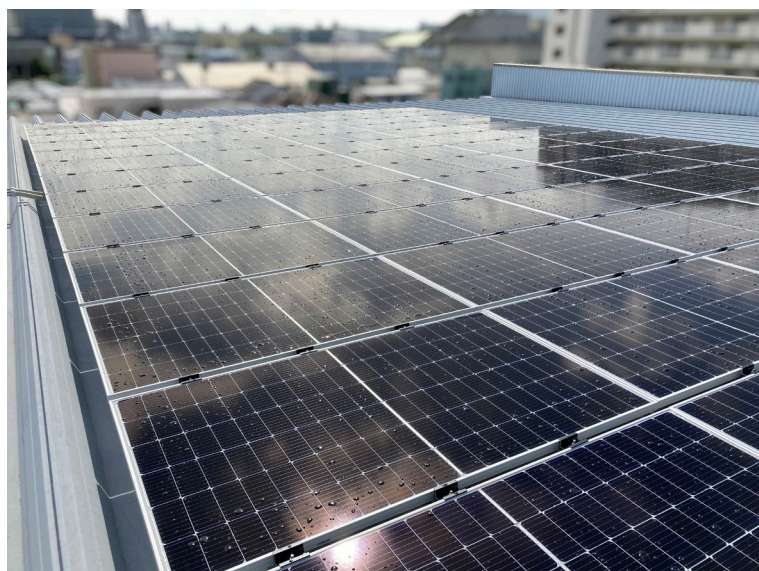
SPK名古屋営業所の屋根に並べられた太陽光発電パネル
